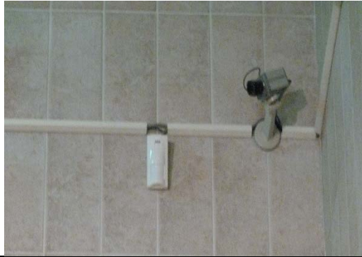
頂樓安全門加裝監視門禁管制
